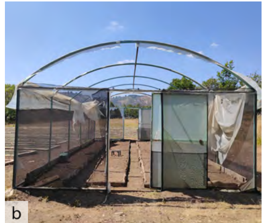
Figura 3.9. Instalaciones del vivero afectadas por fenómenos naturales (a) y falta de mantenimiento (b) que requieren rehabilitación de cubiertas protectoras. (Manuel Aguilera R.).
